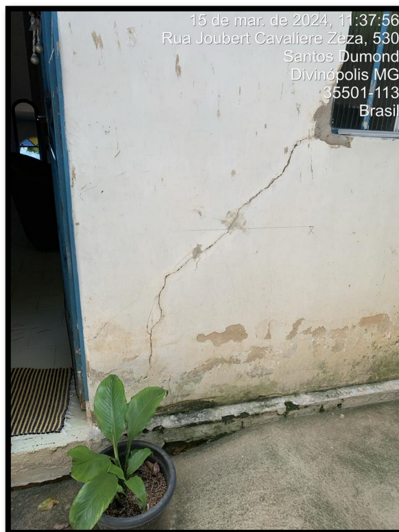
Foto 04 – Vista de trincas na alvenaria do imóvel.
