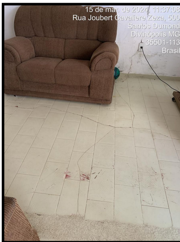
Foto 09 – Vista de trincas no piso do imóvel.
