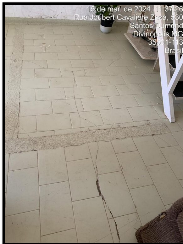
Foto 07 – Vista de trincas no piso do imóvel.
