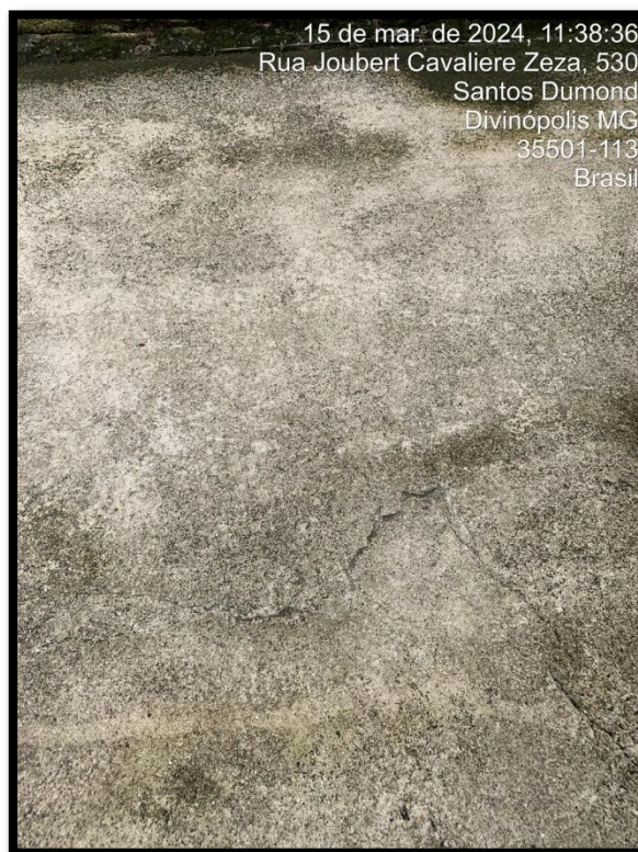
Foto 05 – Vista de trincas no solo da garagem.
