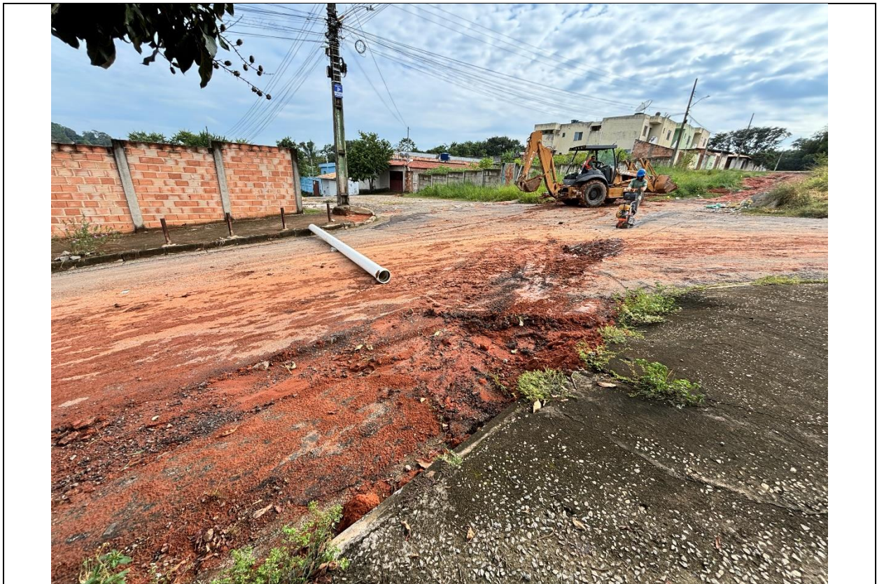
Imagem 01: Obra de extensão da rede municipal de abastecimento de água em curso durante vistoria. Fonte: Próprio autor.
