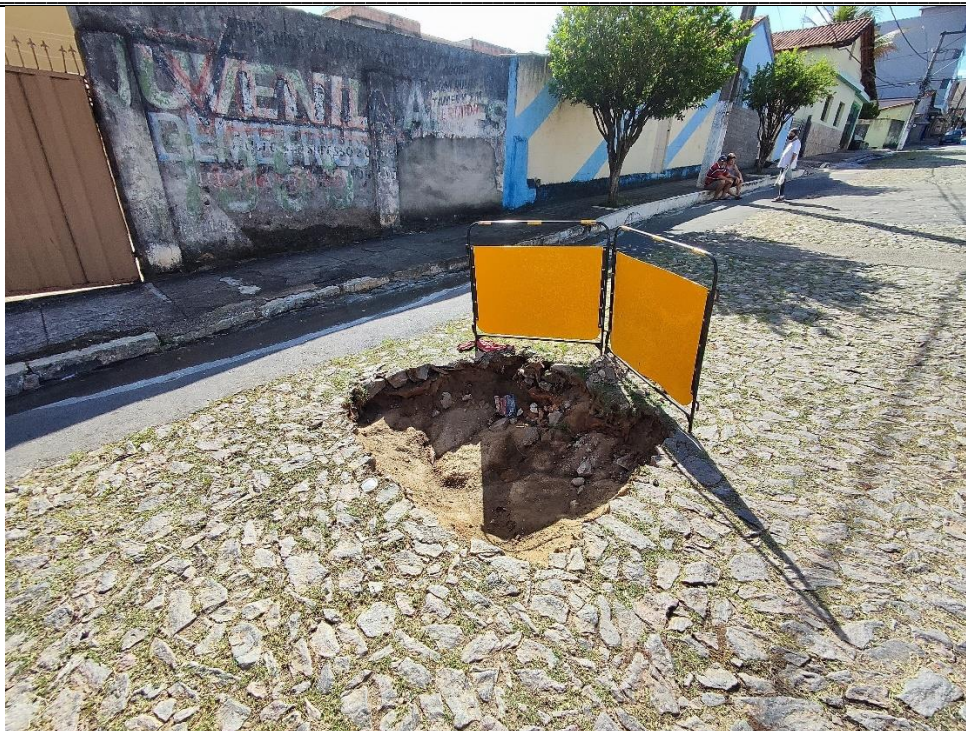
Imagem 02: Vala registrada na rua Antônio Alves Neto próximo ao cruzamento com rua Alberto Coimbra, na data de 16/03/2023 com recomposição pendente. Fonte: Próprio autor.
