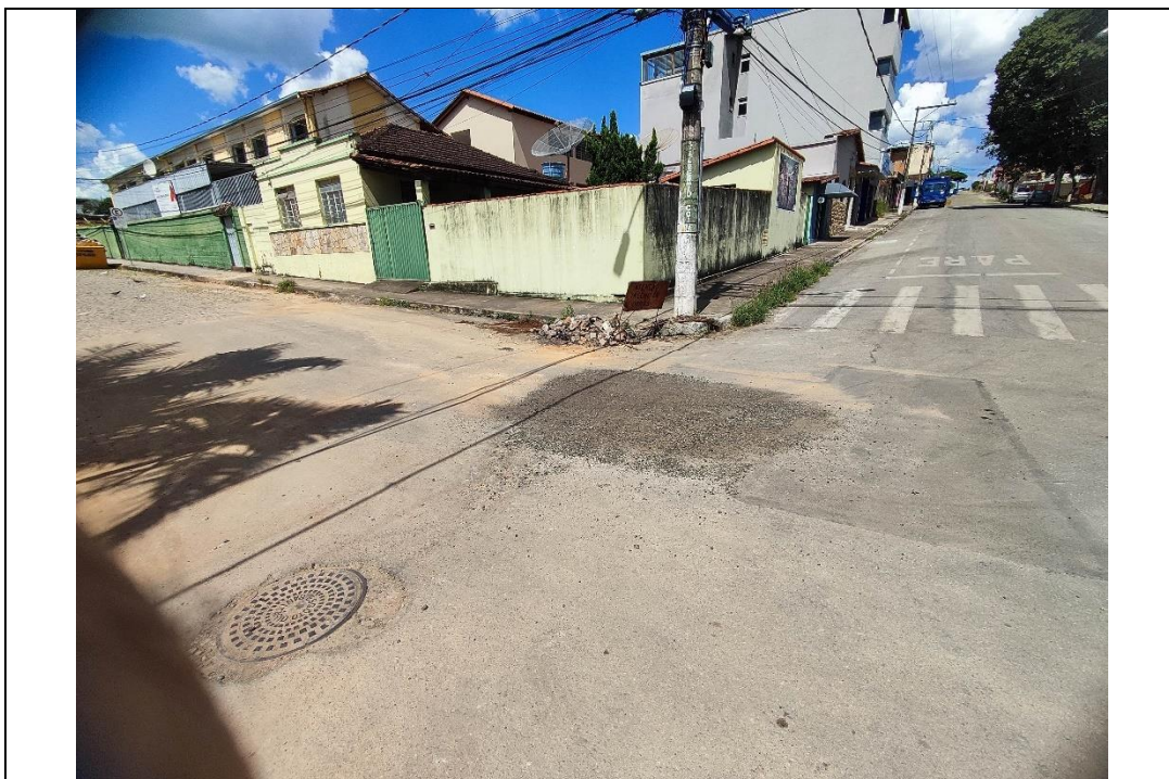
Imagem 01: Vala de manutenção registrada no cruzamento das ruas Antônio Alves Neto e Alberto Coimbra, na data de 04/03/2022 com recomposição de pavimento pendente. Fonte: Próprio autor.
