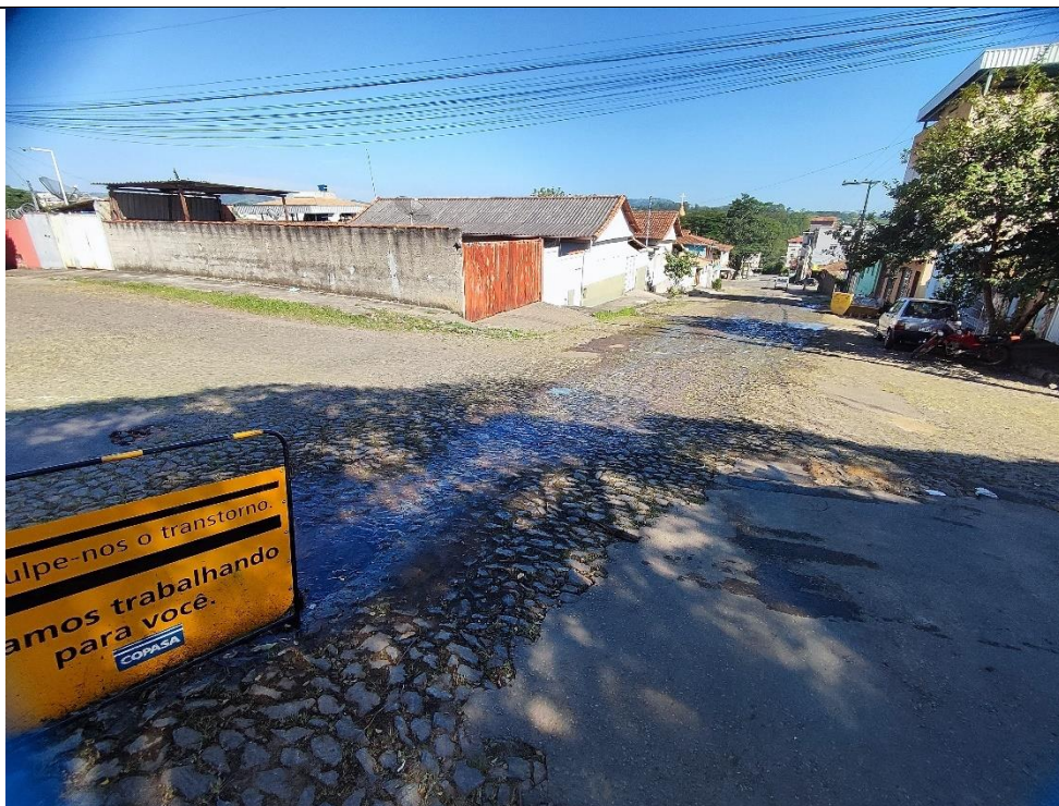
Imagem 03: Vazamento no cruzamento das ruas Antônio Alves Neto e Francisco C. Ribeiro, na data de 30/03/2023 com recomposição pendente. Fonte: Próprio autor.
